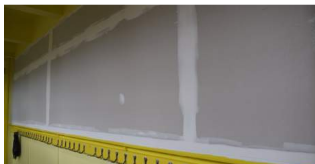
Les fenêtres des salles de classes sont bouchées par des doubles plaques de placo afin de ralentir la propagation du feu en cas d'incendie. Ces plaques doivent être mises en peinture.
